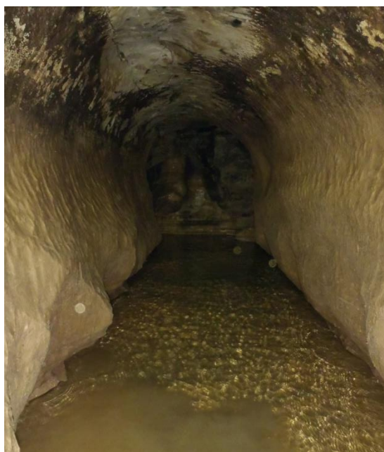
Galerie tubulaire et reprise d'érosion à la base de la galerie
