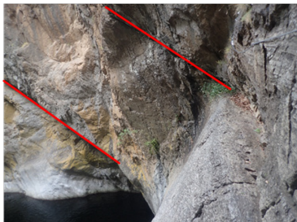
Mise en évidence des failles au niveau de la C25 La lèvre inférieure correspond à la zone de main courante
