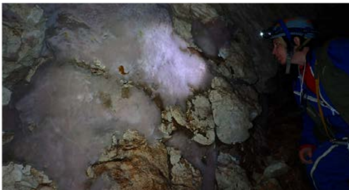
La paroi recouverte par la mérule, le "champignon des maisons", au fond de l'aven d'Aze (photo B. Lips)
