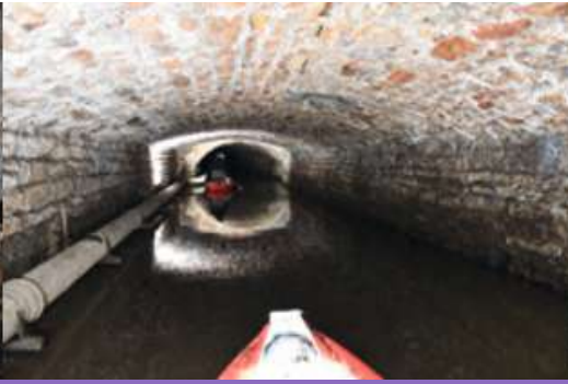
Figure 29 : égouts de Cluny installés dans le cours de La Chaîne qui coule sous la ville.
