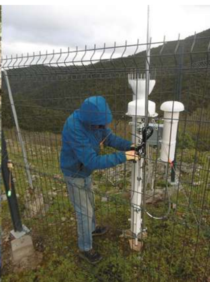
Fig. 7 : la clôture financée par le CDS 11 protège la station hydrométéorologique d'Argentières. Ses données sont capitales pour l'étude du système Chevreuil-Bories-Laïdoux.
