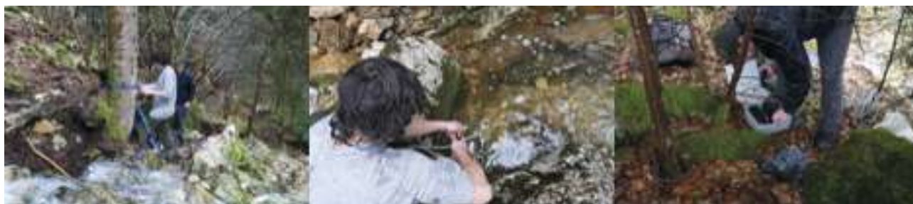
Figures 4, 5, 6 : Installation des fluorimètres.
