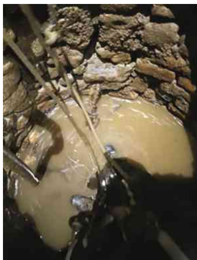
Figure 20 : Pompe installée au fond du puits
